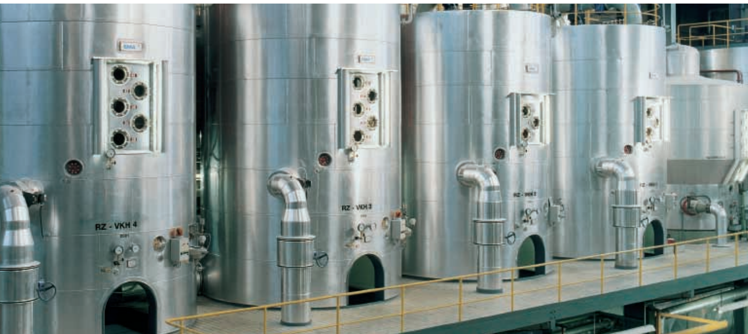
La nouvelle cascade de l'appareil à cuire horizontal VKH à Frauenfeld
