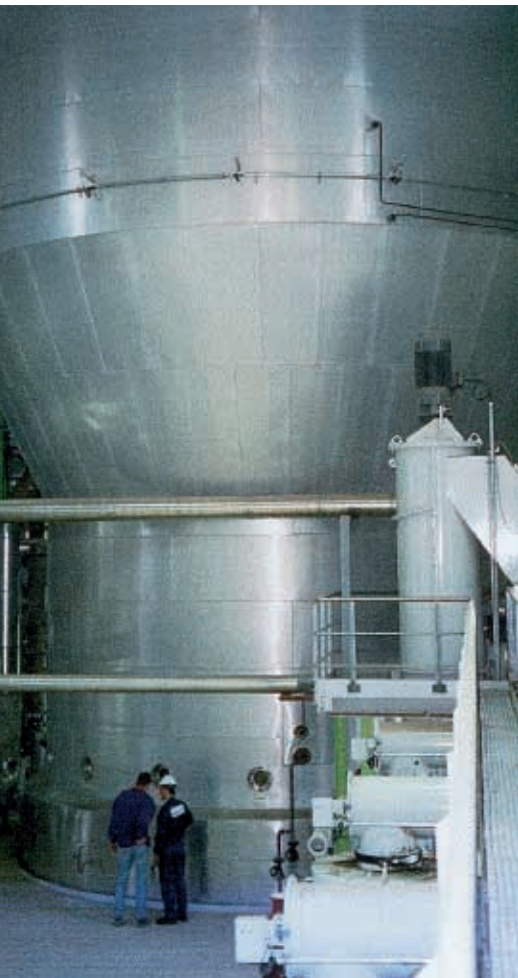
Sécheur à vapeur de la taille 10 à Klein Wanzleben
